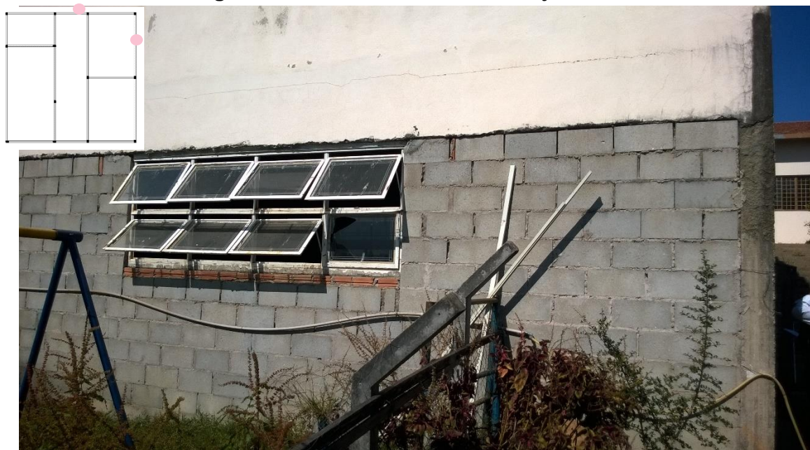
Figura 6 – Trincas de argamassa na junção das vigas com a alvenaria superior.
