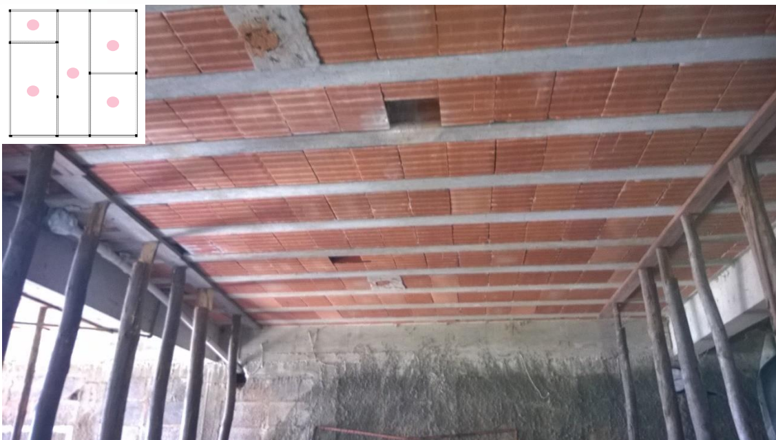
Figura 7 – Lajotas que se soltaram, indicando uma flexão nas vigotas, possivelmente causadas pela flexão nas vigas de apoio.
