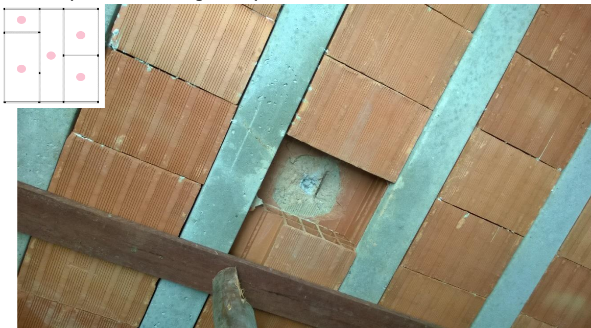
Figura 8 – Detalhe – Lajota solta
