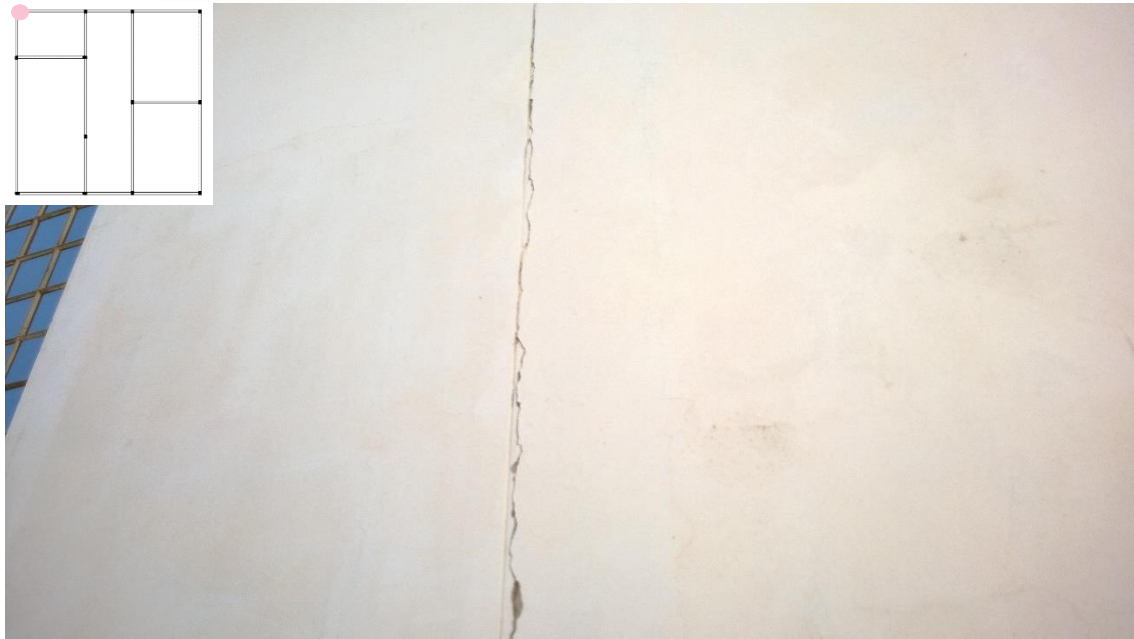
Figura 15 - Trinca externa, na interface da estrutura sob aterro.
