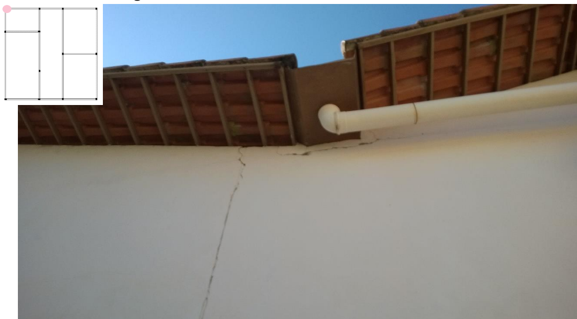
Figura 14 - Trinca externa, na interface da estrutura sob aterro.
