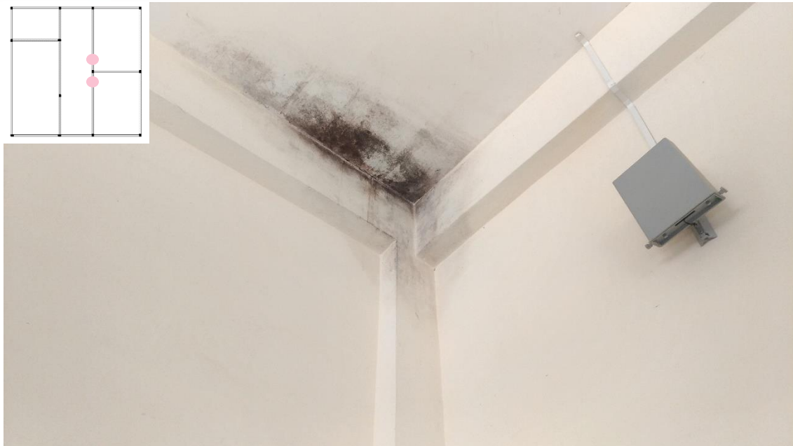
Figura 5 - Vazamento da calha na laje de teto
