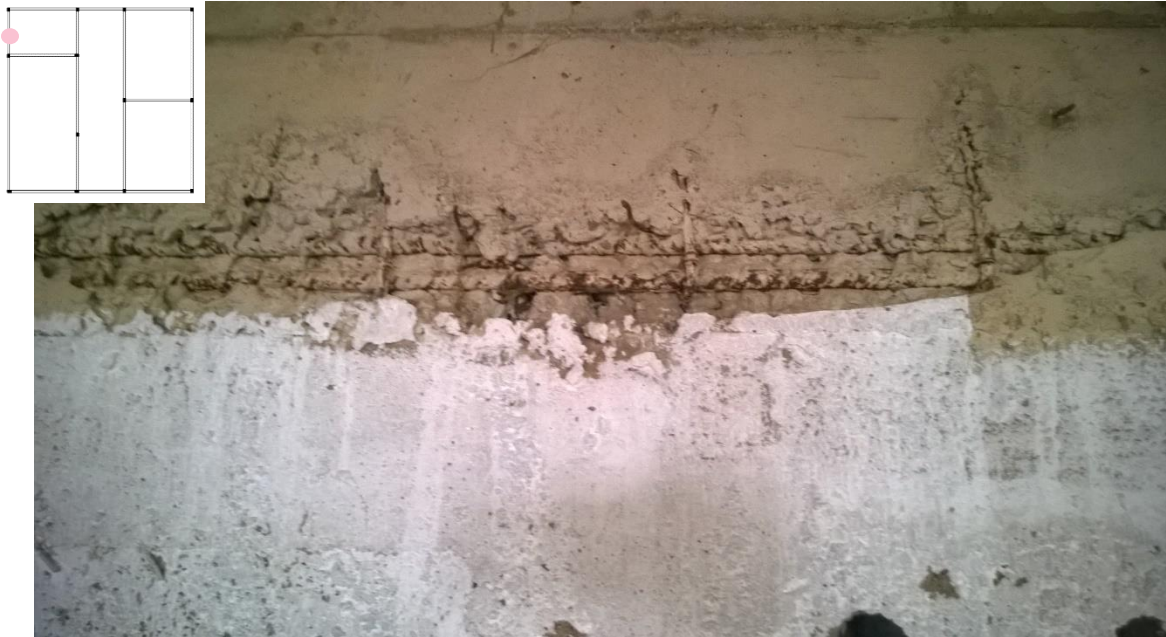
Figura 9 – Armaduras expostas na viga de travamento e sustentação do arrimo lateral.
