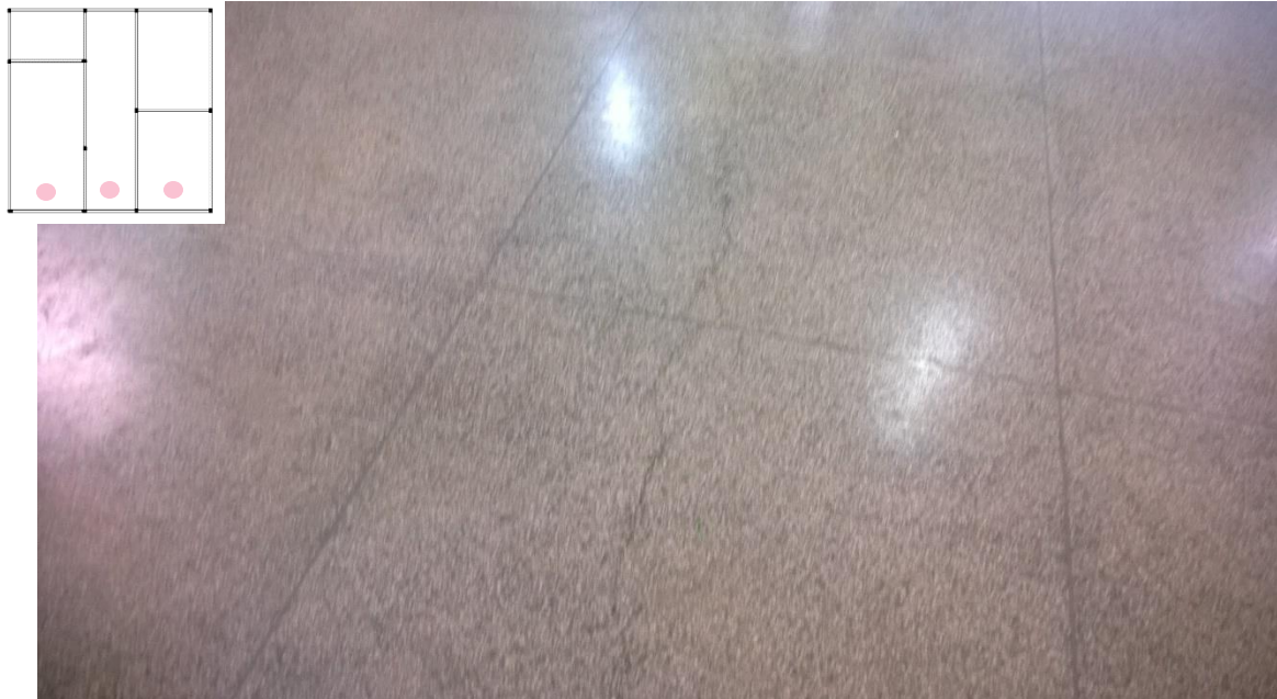
Figura 2 – Rachadura gerada pelo descolamento.
