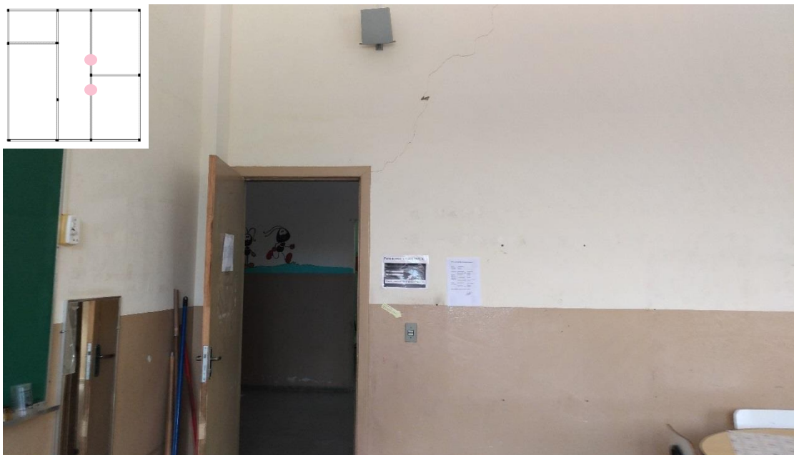
Figura 4 – Fissura 45° no canto direito das portas, indicando que a estrutura cedeu para o lado direito, podendo ser uma viga fletida ou recalque de pilares.
